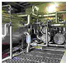
Gli impianti Servel Mera
