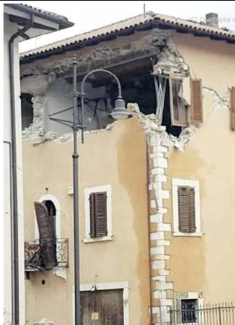
Una delle tante case danneggiate dal sisma
